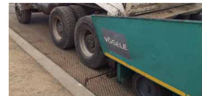
Стабилизация основания с помощью георешетки Тенсар TriAx® повышает надежность конструкции и существенно увеличивает срок службы дорожного покрытия.
